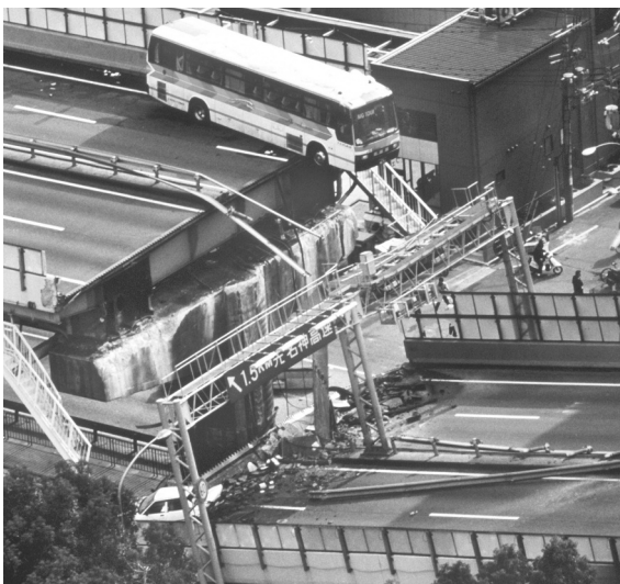
Zerstörte Autobahn nach dem Erdbeben am 17. Januar 1995 in der japanischen Stadt Kobe. © picture-alliance/dpa
