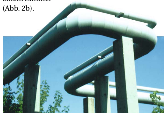
1 Erhitztes Wasser wird in Fernheizungen durch Rohrleitungen gepumpt.
